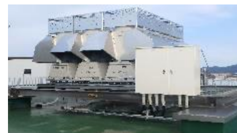
高効率空冷ヒートポンプチラーの導入 [空調管工事]
