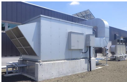
高効率ヒートポンプ式外調機
